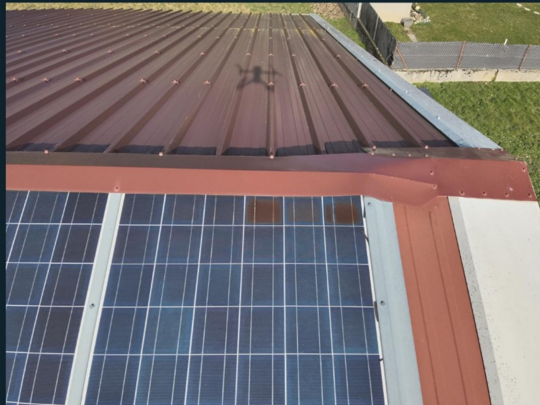
La photo situe la zone au voisinage de la couverture. Ombrage, réflexion ou défaut restent à départager.
